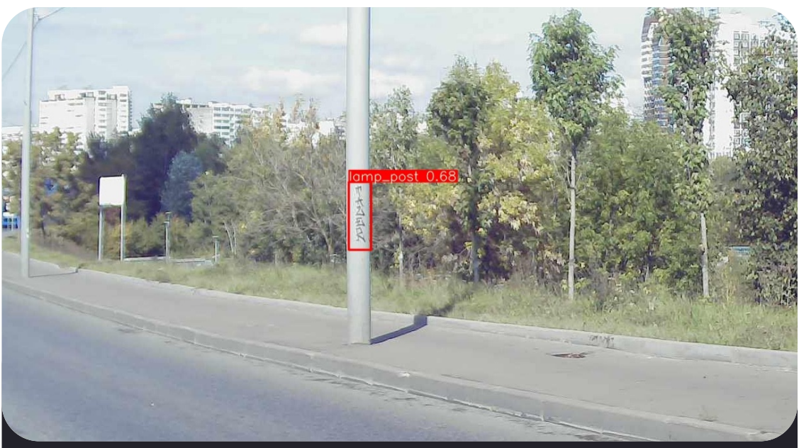
Грязная опора освещения
