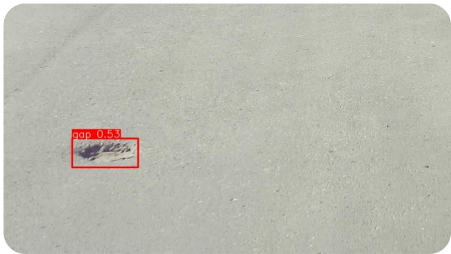
Ямы и выбоины в асфальтированном покрытии
