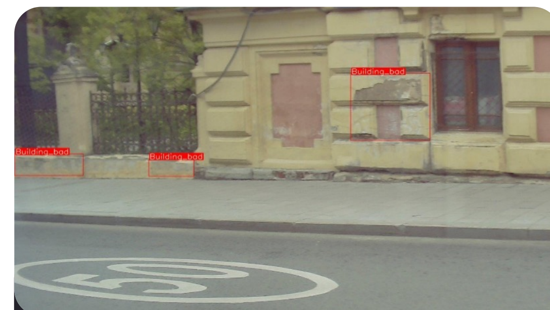
Ветхие здания / Несоответствие градостроительным нормам
